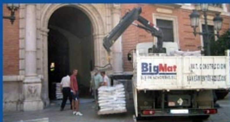
16-7-05 Comienzan en el Palacio Arzobispal de Valencia las obras de lo que será el "apartamento pontificio" en el que residirán el Papa y sus colaboradores durante el EMF.
